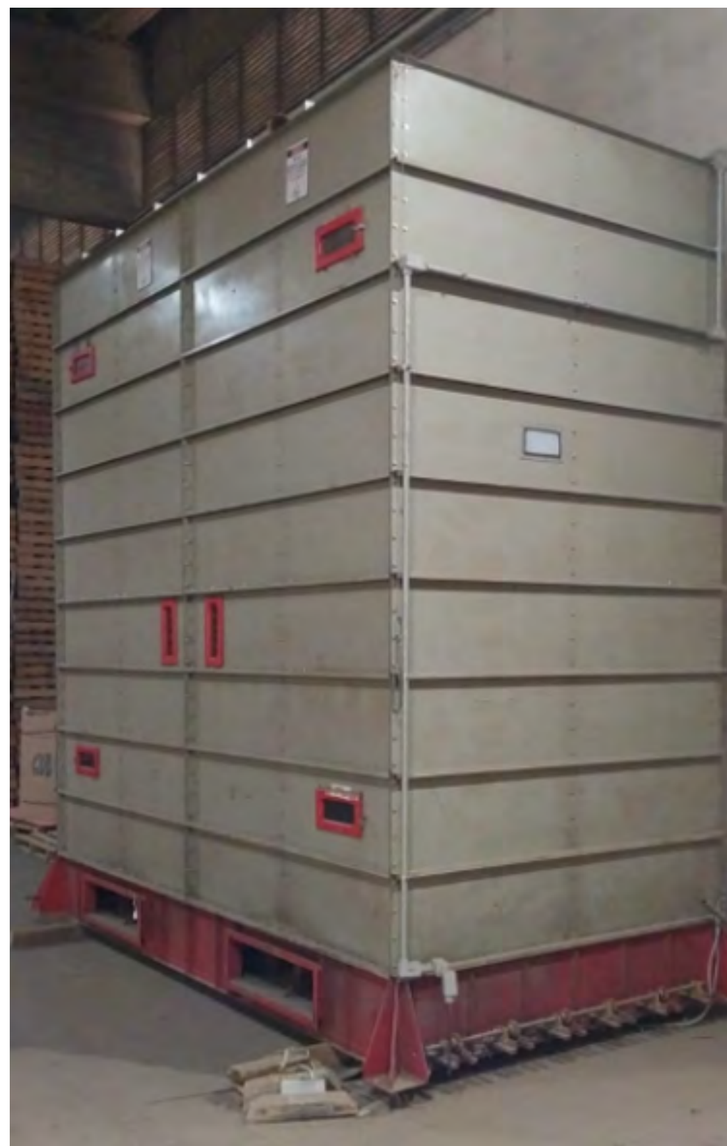
4 - Estação de resfriamento 10t
